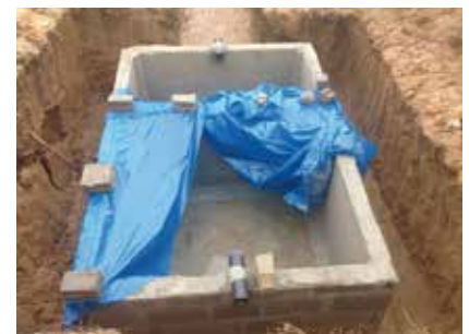
SICKERGRUBE MIT KLÄRANLAGE
